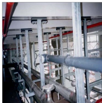
Vibroizolație punctuală CIPREMONT® a structurii de suspensie a unor conducte, fabrica Wacker Siltronic, Singapore
