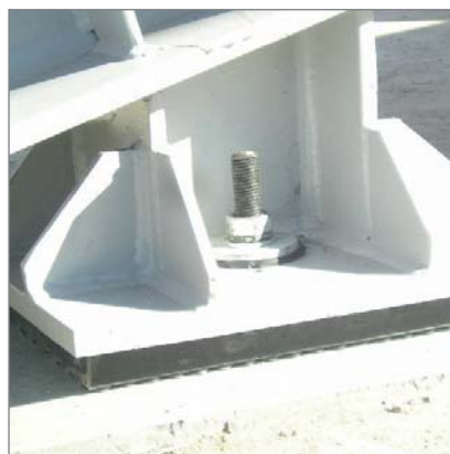
Izolarea punctuală a vibrațiilor (CIPREMONT®) a structurii de oțel a cinematografului din Złote Tarasy din Varșovia
